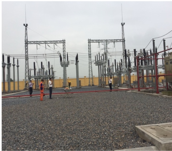
Trạm biến áp 110kV Kim Bảng
